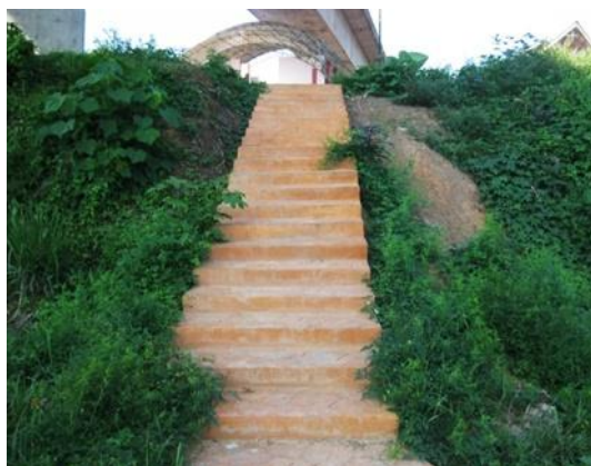
Gambar 2.1 Anak Tangga Dibina Tanpa Railing
