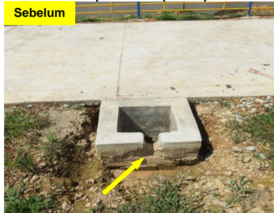
Gambar 2.7 Sump Tidak Berpenutup
