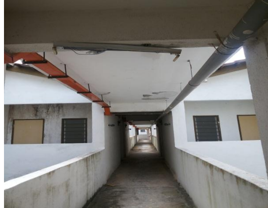
Gambar 1.2 Mentol Lampu Koridor Di Tingkat 9, Blok B Yang Dicuri
