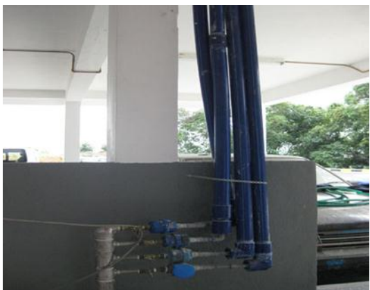
Gambar 2.11 Kerja-Kerja Mekanikal ( Piping ) Kurang Kemas
