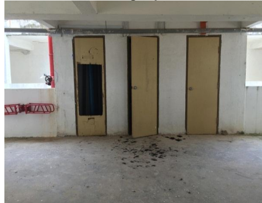
Gambar 1.4 Pintu Saluran Paip Bomba Di Tingkat 8 Blok B, Yang Dipecahkan
